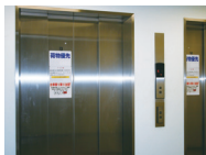
荷物用エレベーター
